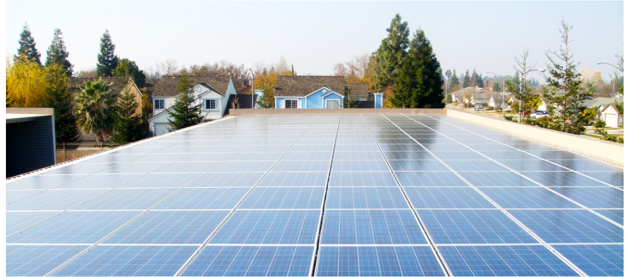
▲ 20 MW 德国 / Germany 中来FFC背板 (建设于2012年) / Jolywood FFC Backsheet (Built in 2012)
