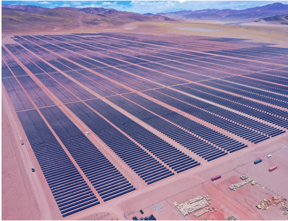
▲ 315 MW 阿根廷 / Argentina 中来FFC背板 (建设于2018年) / Jolywood FFC Backsheet (Built in 2018)
